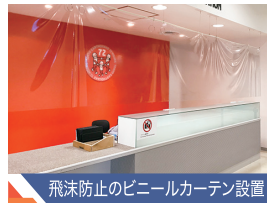
飛沫防止のビニールカーテン設置
